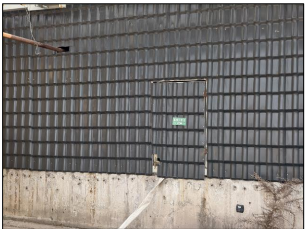
盛隆泰达甲醇分公司现有 3000m 3 事故水池
