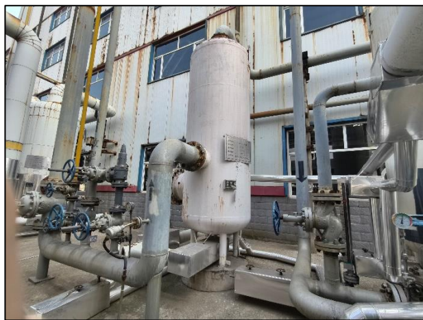
盛隆泰达天然气分公司现有富甲烷气缓冲罐
