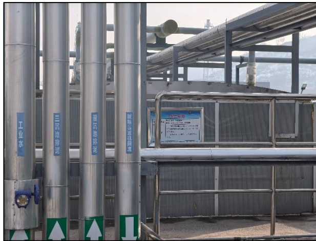
盛隆泰达焦化厂现有污水处理站
